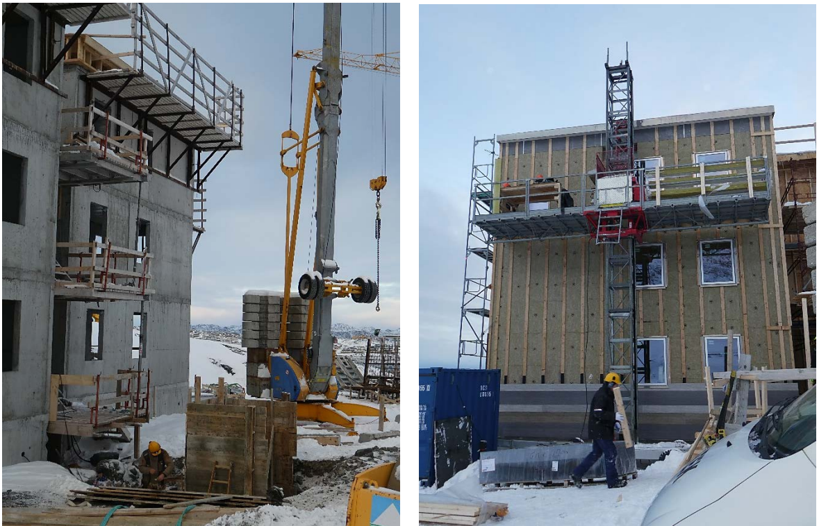
Fig.1. Fotos fra opførelsen af Unaaq-byggeriet viser ydervæggenes konstruktion. Tv den rå insitu-støbte beton, th er isolering og vinduer monteret, og den udvendige beklædning er ved at blive sat op.
