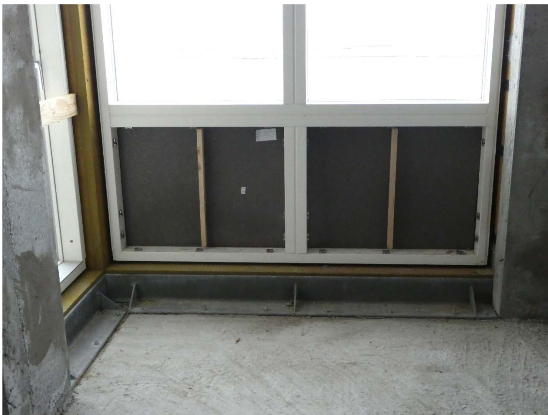
Fig. 13. Foto af let facadeparti taget under opførelsen. Isolering af facadepartier samt etablering af dampspærre og indvendig beklædning (MDF plade) sker på pladsen. Bemærk at partiet er fastgjort til stålbeslag (ikke synligt) svejst til 150 x150 mm vinkelprofil i stål, der er fastgjort til betondækket.
