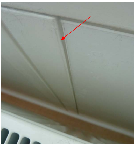
Fig. 16. Nærbillede af det lette brystningsparti bag radiatoren. Der er efterfugnet i samlingerne med klar fugemasse. Afprøvninger med røgpinde sandsynliggjorde at samlingen nu er lufttæt.
