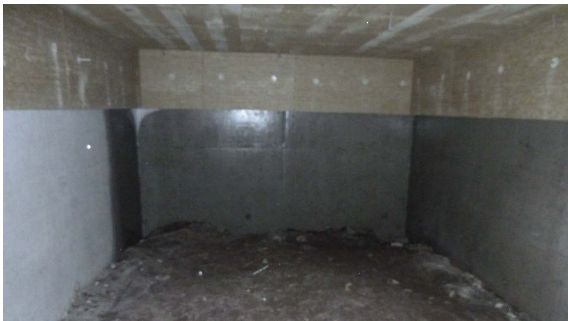
Fig. 26. Krybekælder under nr. 19. Der er isoleret på dæk mod stueetage og ca. 60 cm ned. Endevæggen mod øst er våd, hvilket også gælder den del af skillevæggen, der ligger under karnappen.
