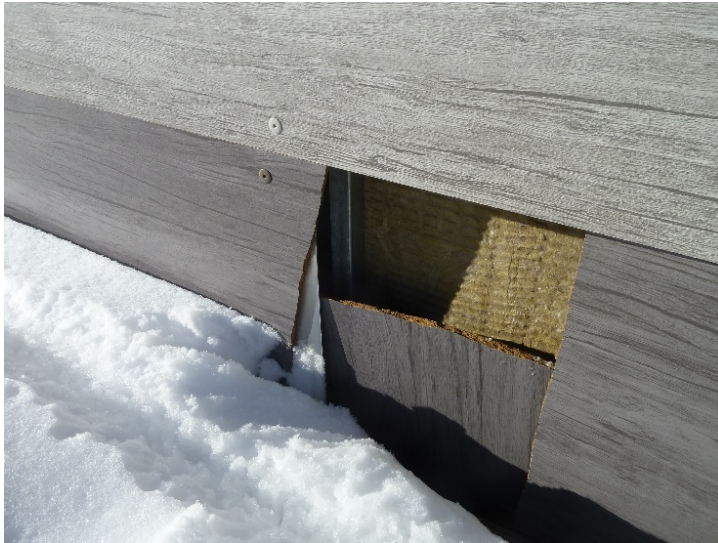
Fig. 11. Ødelagt plade på nr. 17. Det er formentlig sket ved påkørsel. Det er vanskeligt at demontere og udskifte plader, fordi de er fastgjort med popnitter og ikke skruer.
