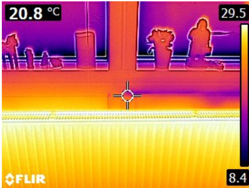
Fig. 17. Termografibillede af samling mellem vindue og brystningsparti. Der er tydelig kold stribe (mørk) under den højre side af vinduet, hvilket kunne tyde på en utæt fugt. Der er ikke en tilsvarende stribe under venstre vindue. At overfladetemperaturen i området er relativ høj, skyldes opvarmning fra radiatoren.
